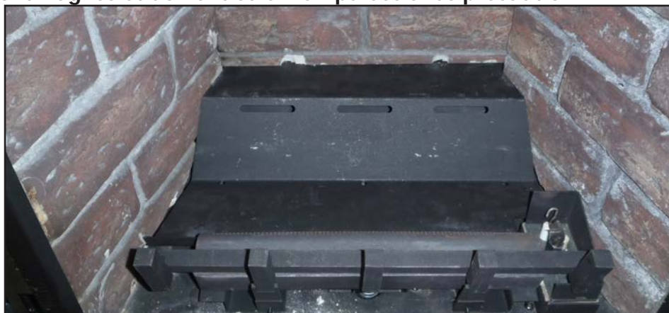
Figure 58: Foyer vide avec grille et goupilles de positionnement.
