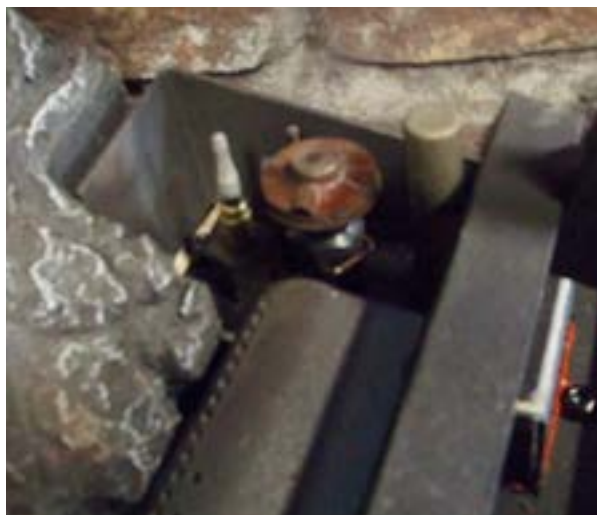
Figure 15. Ensemble de pilote à côté du brûleur.
