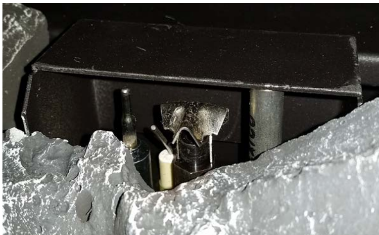
Figure 18. Ensemble de la veilleuse a côté du brûleur.
