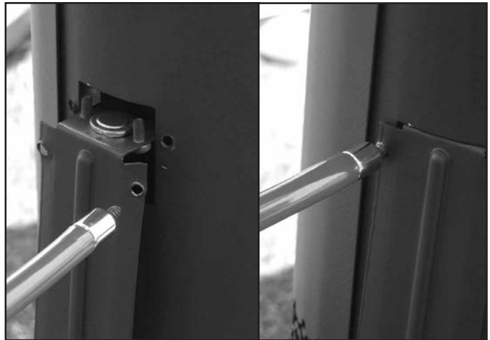
Figure 35: L'installation de l'interrupteur de déversement.
