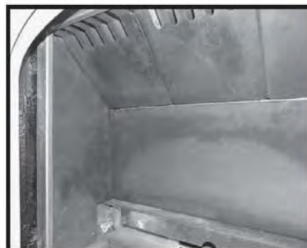
Fig. 88: Trois déflecteurs installés
