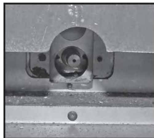
Figure 78: Orifice du brûleur (vu de l'intérieur de la chambre de combustion)
