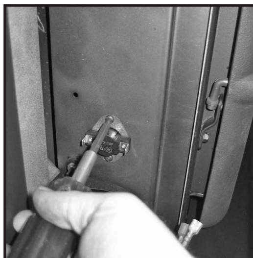
Figure 22: Réinstallation du thermocouple sur le côté gauche.
